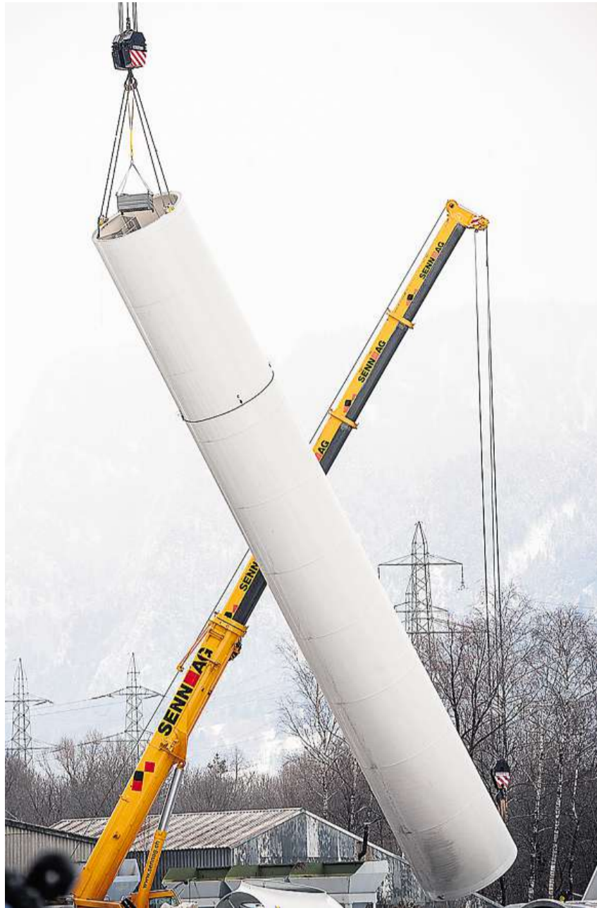
Ein imposantes X: Mit dem Aufbau der schweizweit grössten Windenergieanlage in Haldenstein wird ein Stück Bündner Energiegeschichte geschrieben.
